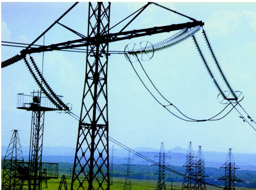
Рис. 11.11. Воздушная линия постоянного тока \pm 400 кВ на металлических свободстоящих опорах
