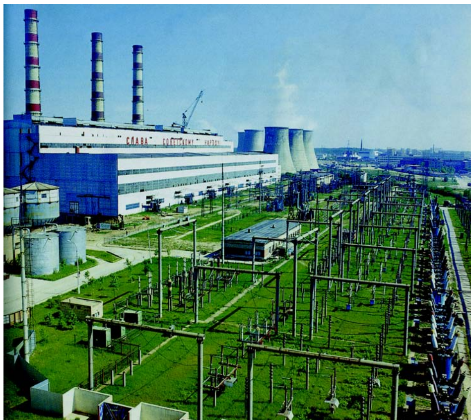
Рис. 4.1. Открытое распределительное устройство (ОРУ) ТЭЦ-21 Мосэнерго
